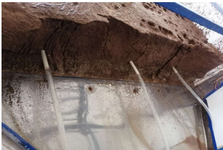
شکل ۱۰. ریزش اتفاق افتاده در شیب ۱۴ درصد همراه با موقعیت لوله‌های موجود در خاک
