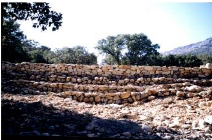
شکل ۳. یکی از سدهای اصلاحی آبراهه تنگ تیر
